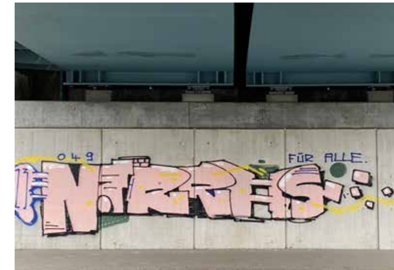
Kaum wurde die neue Brücke an der Kewerstraße freigegeben, wurde sie auch schon beschädigt. Foto: Peter Klunk
